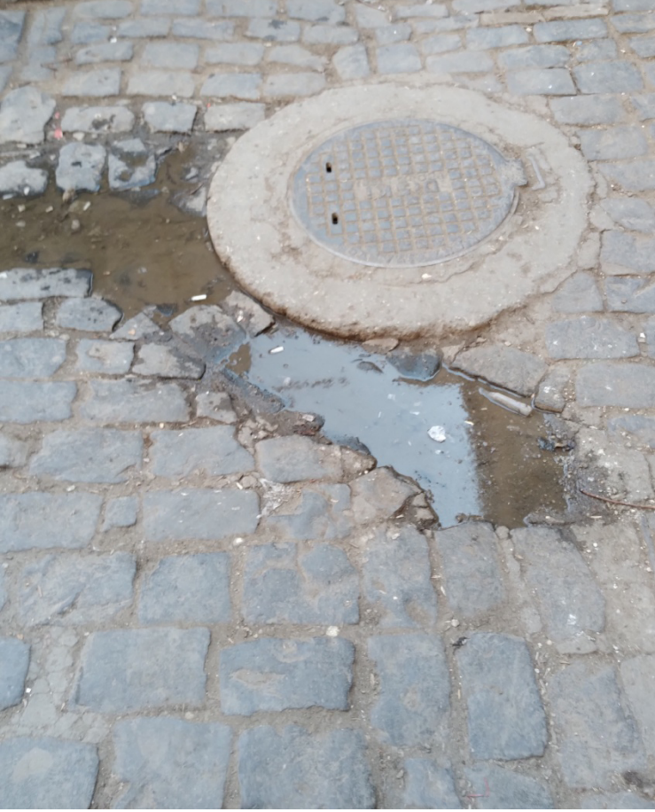
Fotoğraf 16: İskender Paşa Mahallesiinde Bir Sokak
